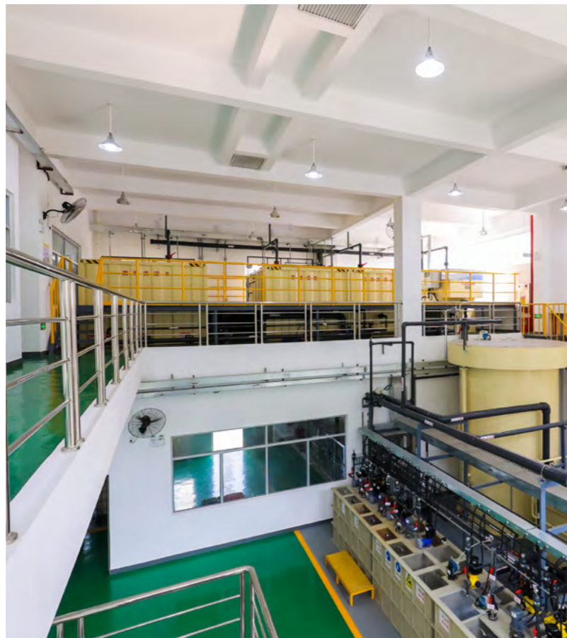
日立电梯大石基地污水处理系统
